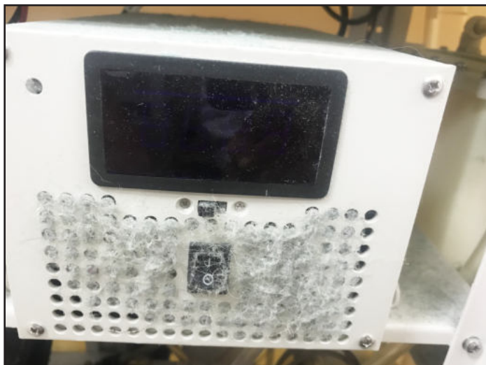
Фото. 6.1. Перекрытие отверстий вентиляционной системы крупным мусором.
