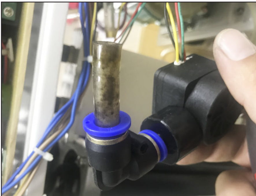
Фото. 3.1. Бактериальные засорения в патрубках аппарата, который был законсервирован с нарушением – не была слита вода.
