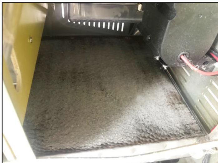
Фото. 6.2. Радиатор системы охлаждения, покрытый плотным слоем пыли.
